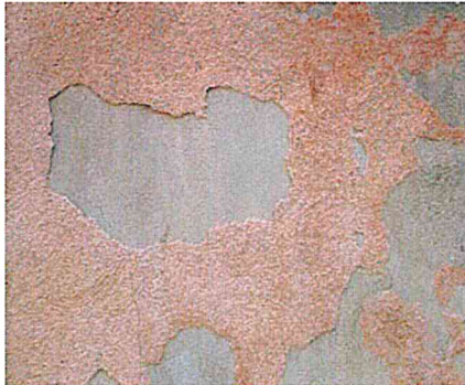
Particolare dei fenomeni di degradazione della finitura di cocciopesto.
