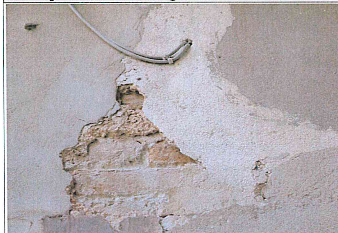
integrazioni cementizie al piano terra lacune negli strati di intonaco e finitura
