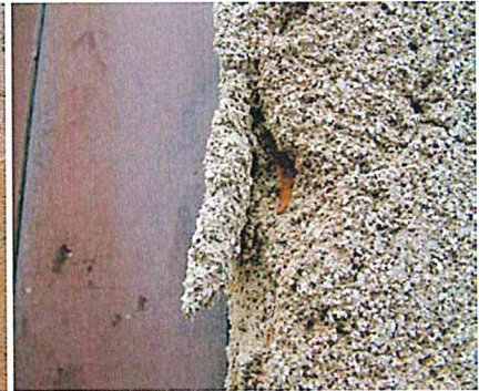
Particolare del degrado dell' intonaco risanante a base di perlite: l'intonaco, in alcuni punti è friabile e si stacca a piccoli pezzi.
