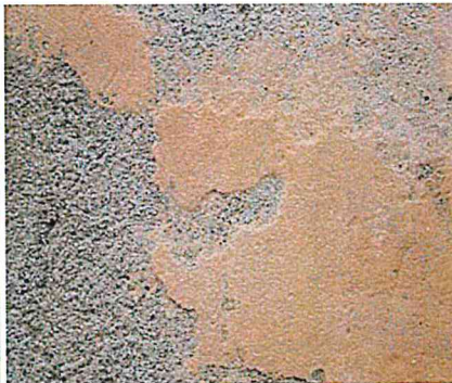
Particolare dell'erosione della rifinitura applicata sull' intonaco risanante a base di perlite.
