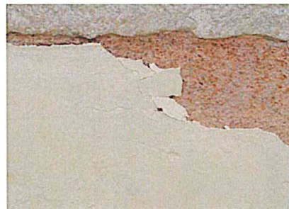
Particolare del degrado della finitura a "marmorino". La finitura si fessura e si stacca a pezzi.
