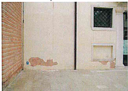
Chioggia – Edificio con intonaco di cocchiopesto moderno e finitura definita a "marmorino".
