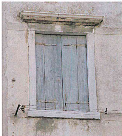
Apertura tipo, cornici e trabeazione in pietra d'Istria e mattoni, infisso a pannelli di legno
