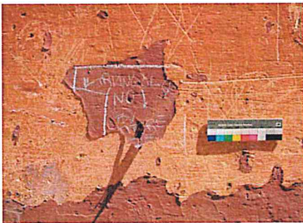
Chioggia - Tinteggiatura pellicolante di colore più scuro rispetto alla finitura tradizionale a calce. Da notare la migliore tenuta della tinta a calce rispetto a quella sovrapposta di tipo sintetico.
