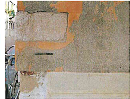
Particolare del distacco e della perdita della finitura di cocciopesto.
