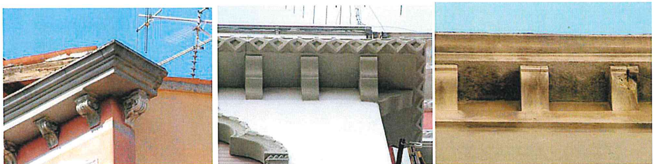
Chioggia - Cornicioni realizzati in "pietra artificiale". Nell'ultima immagine a destra è chiaramente visibile il ferro dell' armatura interna di una mensolina del cornicione.
