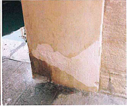
Chioggia- Edificio in Calle Rugoli. Particolare del degrado dell' intonaco deumidificante macroporoso
