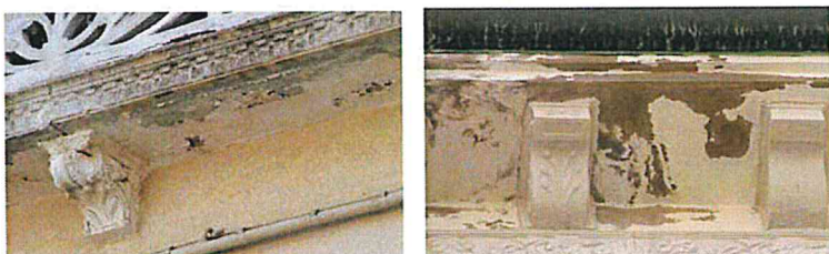
Elementi in pietra naturale e artificiale sottoposti a pittura. Sono evidenti i fenomeni di distacco e esfoliazione della pellicola pittorica.
