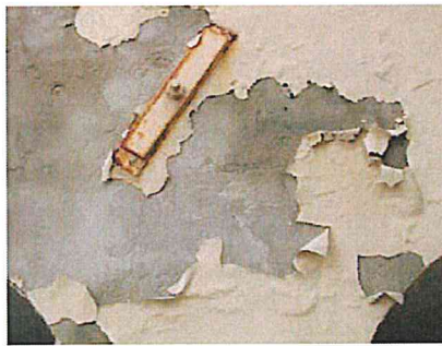
Chioggia - Tinteggiatura pellicolante su intonaco cementizio. Da notare il tipico distacco a effetto "carta da parati".
