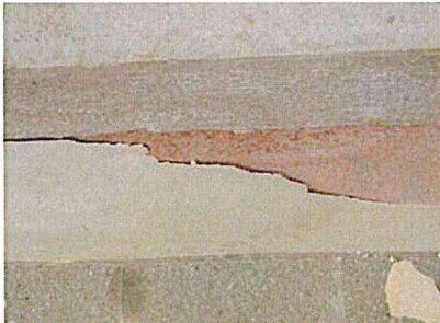
Particolare del distacco della finitura a "marmorino".
