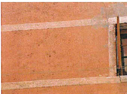
Chioggia – Edificio con intonaco di cocchiopesto e finitura di cotto macinato in polvere. Particolare della facciata con le fasce marcapiano dipinte di bianco.
