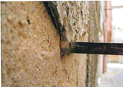
Particolare del distacco del basamento di malta cementizia dallo strato di sottofondo di malta composita.
