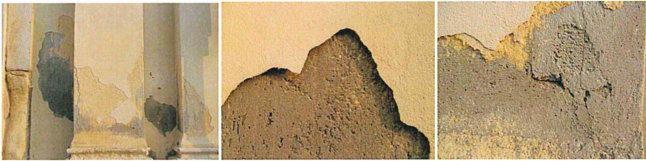
Chioggia – Chiesa di S.Andrea. Particolare della zona basamentale esterna dove è stato applicato un intonaco risanante a base cementizia
