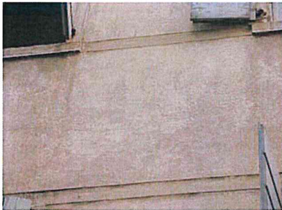
Chioggia – Edificio con intonaco di cocchiopesto e finitura a "marmorino" Particolare della facciata con le fasce marcapiano in rilievo.
