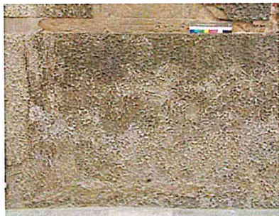
Chioggia – Edificio con basamenti di malta cementizia applicata su un intonaco di malta composita.
