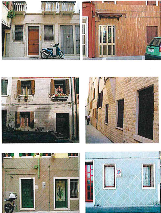
Chioggia e Sottomarina - Rivestimenti sino al primo piano realizzati in epoca recente con materiali e/o soluzioni tecniche estranei alla tradizione locale.
