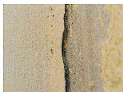
Particolare del distacco della finitura a "marmorino".
