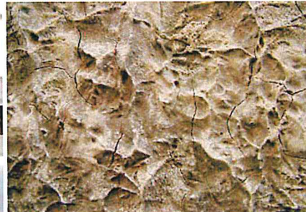
Particolare del basamento di malta cementizia. E' visibile l'accentuato fenomeno di cavillatura che favorisce le infiltrazioni di acqua piovana
