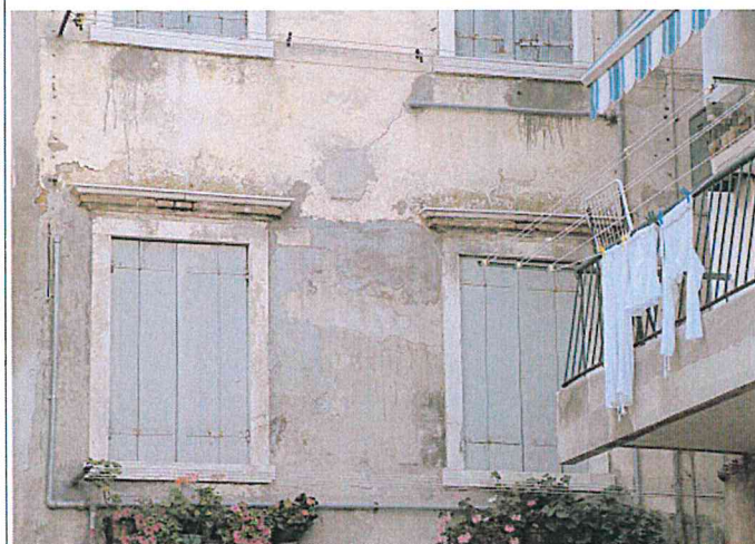
Vista dell'intonaco nel complesso e delle ampie integrazioni cementizie al piano terra
