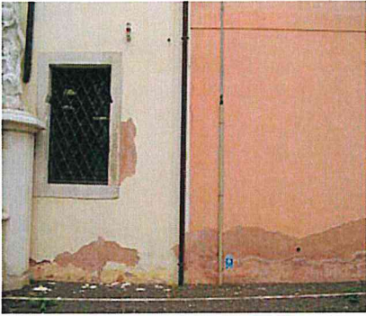
Chioggia – Palazzo Grassi. Particolare della zona basamentale dove è stato applicato un intonaco da risanamento a base di cocchiopesto .
