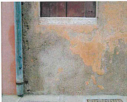
Chioggia – Edificio in Calle Luccarini. Particolare della zona basamentale dove è stato applicato un intonaco risanante a base di perlite.
