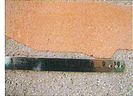
Foto macro della finitura di cocciopesto. In questo caso all'impasto è probabilmente stata aggiunta una forte percentuale di prodotti sintetici.
