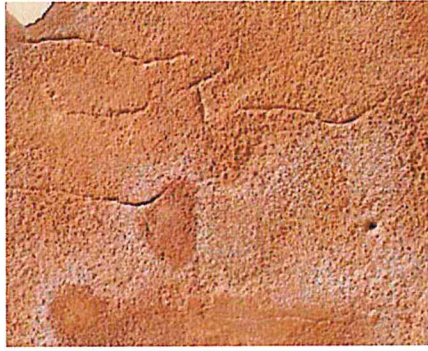
Particolare del degrado dell'intonaco di risanamento a base di cocchiopesto.
