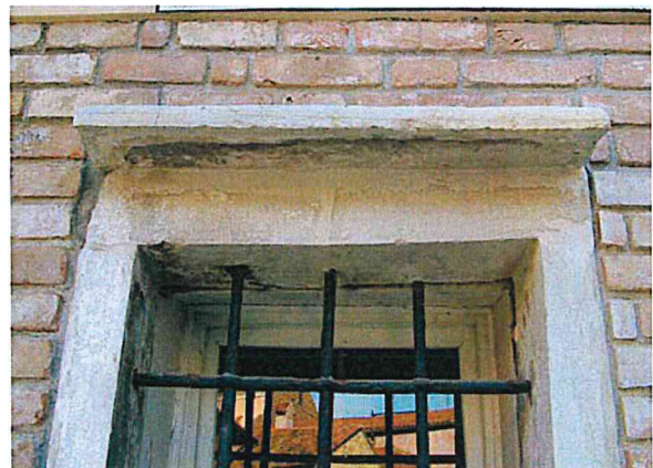
Stuccatura della fessurazione della lesione
