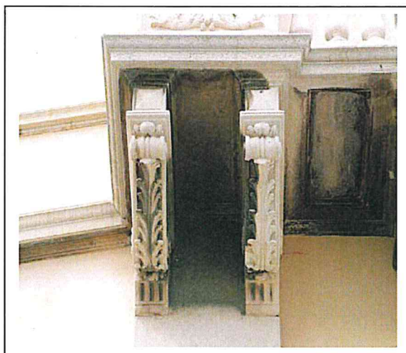
Chioggia- Croste nere su un balcone in "pietra artificiale". In casi di questo genere la pulitura con spray d'acqua si rivela efficace. Nel caso della "pietra artificiale", bisogna porre attenzione alla presenza di ferri di armatura a vista che andranno adeguatamente protetti
