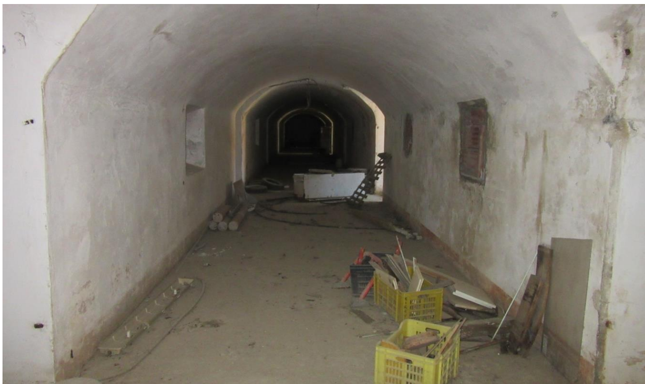
10 e 11_ Viste dell'edificio che evidenziano come la struttura versi in uno stato di abbandono.
