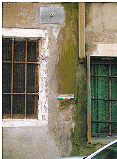
Sottomarina - Formazione di patine biologiche in corrispondenza della perdita di un canale di scolo delle acque meteoriche.
