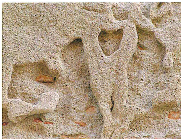
Particolare dell'intonaco dell'immagine precedente. La superficie si presenta fortemente degradata a causa dei sali.
