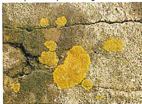
Intonaco - Formazioni di patine biologiche scure e di licheni crostosi di colore giallo.
