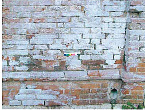
Chioggia - Efflorescenze saline su un intonaco di malta bastarda e su una muratura in mattoni
