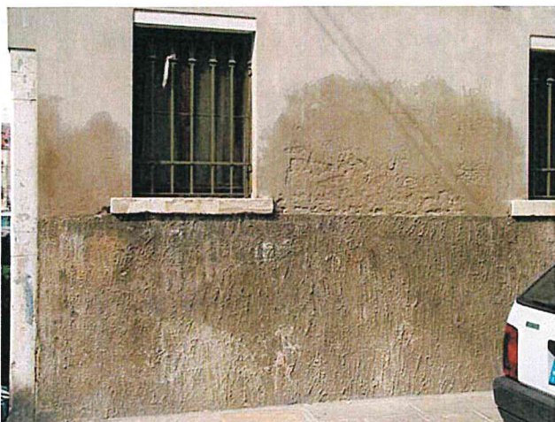
Chioggia- Tipica macchia scura provocata dall'umidità di risalita capillare.
