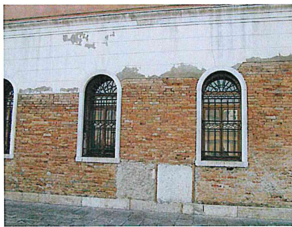
Chioggia -Perdita dell'intonaco a causa della cristallizzazione dei sali. L'altezza di adescamento dell'umidità in questo caso è particolarmente alta (oltre i 4m)
