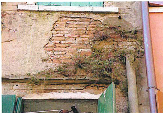
Sottomarina - Attecchimento di vegetazione in corrispondenza di una lacuna nell'intonaco
