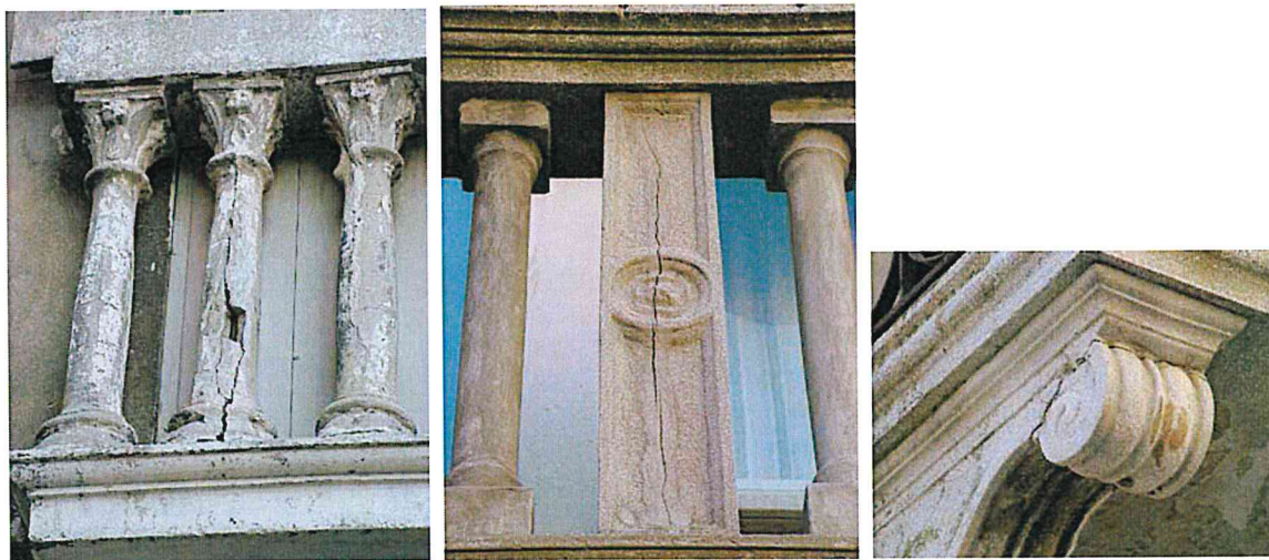
Fenomeni di fessurazione dovuti all'aumento di volume dell'armatura interna provocato dall'ossidazione del ferro.
