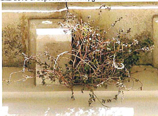
Chioggia - Attecchimento di vegetazione in corrispondenza della fessurazione di un cornicione
